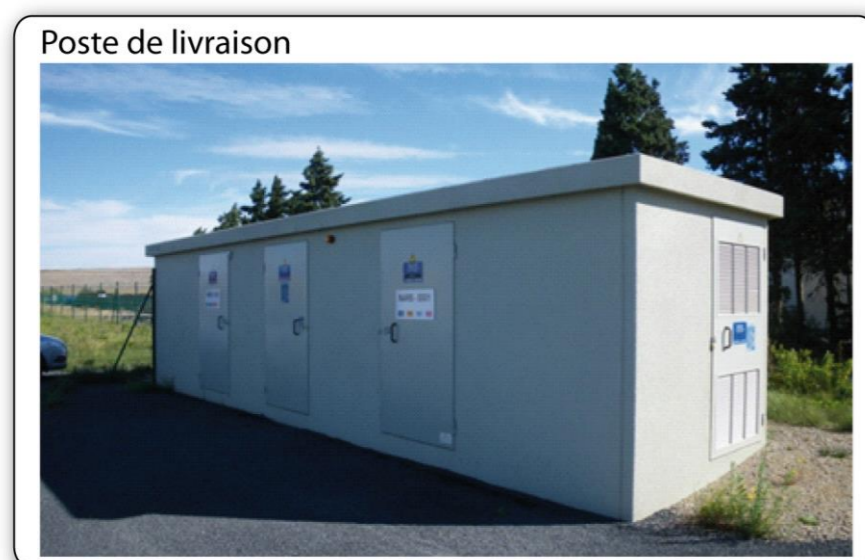
Photographie 2 : Poste de livraison
